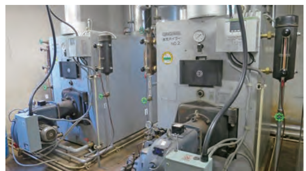
図22 蒸気ボイラー
