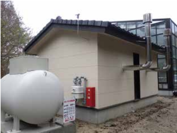
図16 新しいボイラー室.
