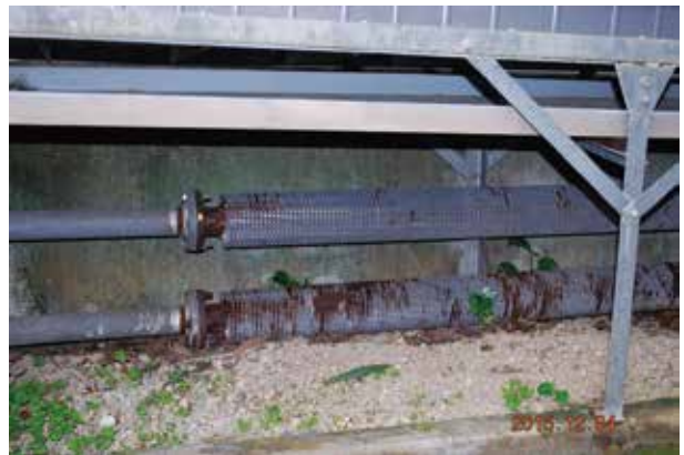
図6 ギルドの腐食.
